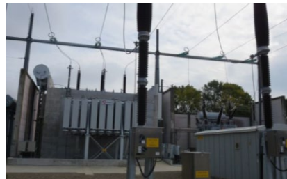
Poste de Faradière Ajout TR 225kV 642
