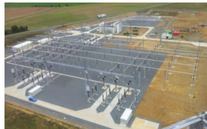
Poste neuf 400kV Molière
