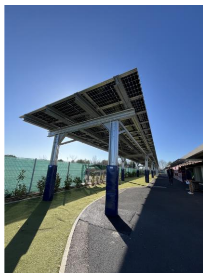
Centrale photovoltaïque installée à la Maison des enfants à Mauguio (2/1)
