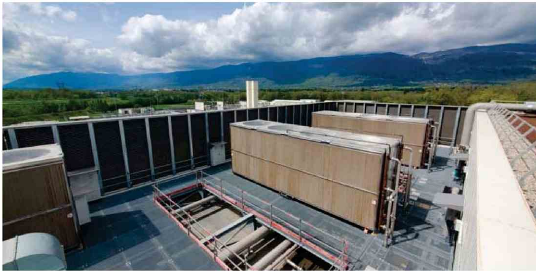
Le nouveau datacenter du CERN se situe à Prévessin-Moëns (Ain), à quelques kilomètres du site historique de Meyrin (Suisse). Opérationnel depuis février, il héberge désormais l'équivalent en données de 4MW de puissance d'alimentation électrique et de refroidissement. Et pourrait monter à 12 MW à l'avenir, en fonction des investissements réalisés. (Crédits : CERN / Equans)
