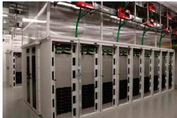
Le nouveau datacenter du CERN permet de soutenir l'accroissement de la puissance de traitement des données. Source : ER/ LaTribune.
