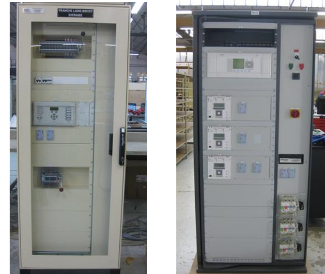
Armoires de contrôle commande
